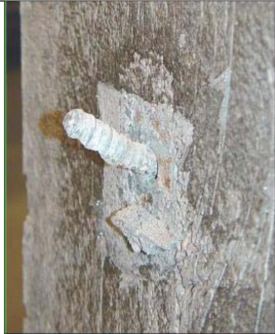
Fig. 12. Parte filettata del connettore dopo la rottura (lato travetto)
